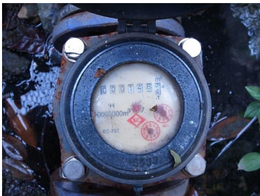
發現流量計故障 無法正常計量
